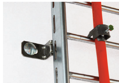
Distanzierte Befestigung mittels Steigleitungswandbügel
