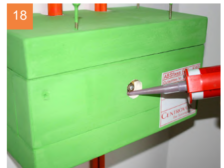
18 Die Öffnungen zwischen Kabel und Deckel und die Sacklöcher mit Brandschutzsilikon verschließen. Hervorquellendes Material glattspachteln.
