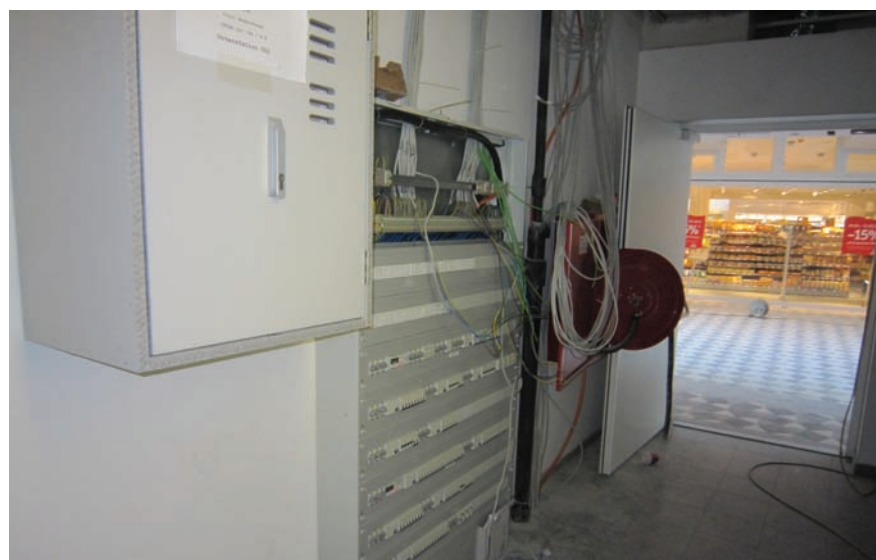
Da der Verteiler eine hohe Brandlast darstellt, ist seine Positionierung auf einem Fluchtweg nur mit Maßnahmen wie die Brandschutz-Einhausung von Priorit möglich.
